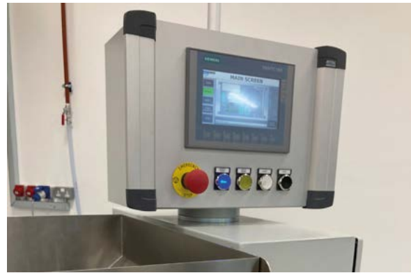
PANNELLO DI CONTROLLO
