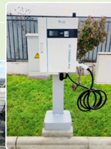
Neue Ladestationen: Bossard China – Eine der vier neu installierten Ladestationen
