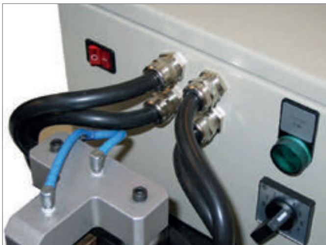
Maschinensteuerung mit PERFECT Kabelverschraubung Machine control with PERFECT cable gland
